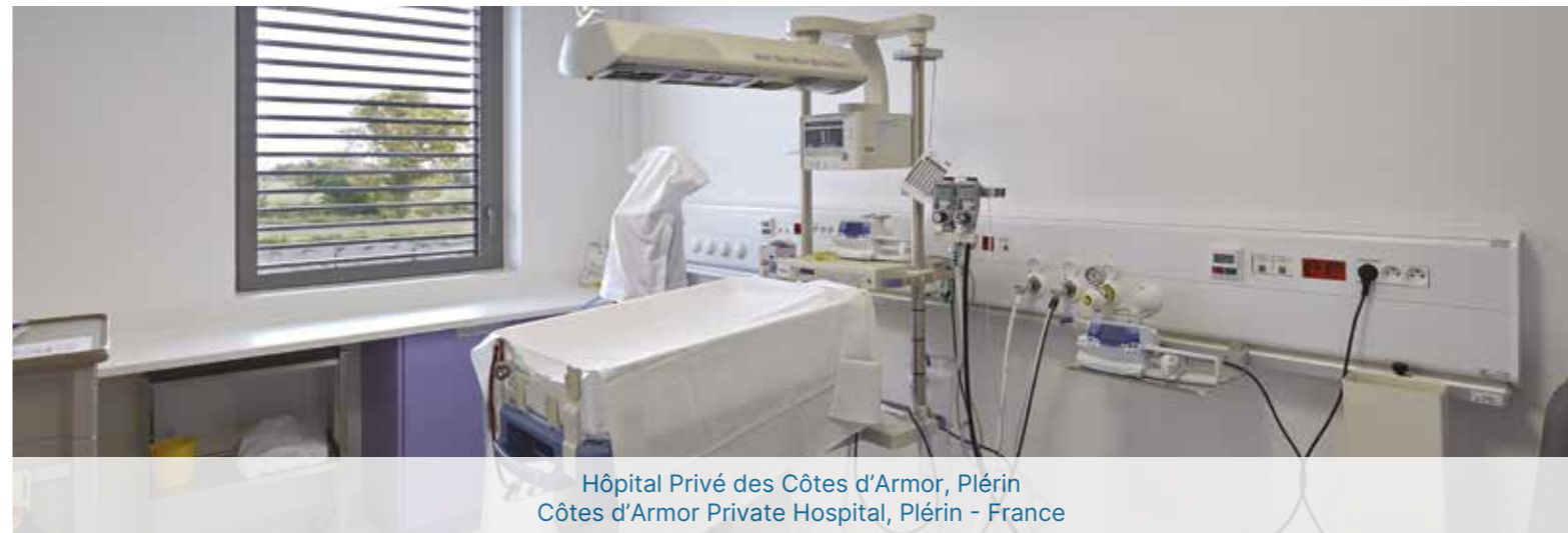
Hôpital Privé des Côtes d'Armor, Plérin Côtes d'Armor Private Hospital, Plérin - France
