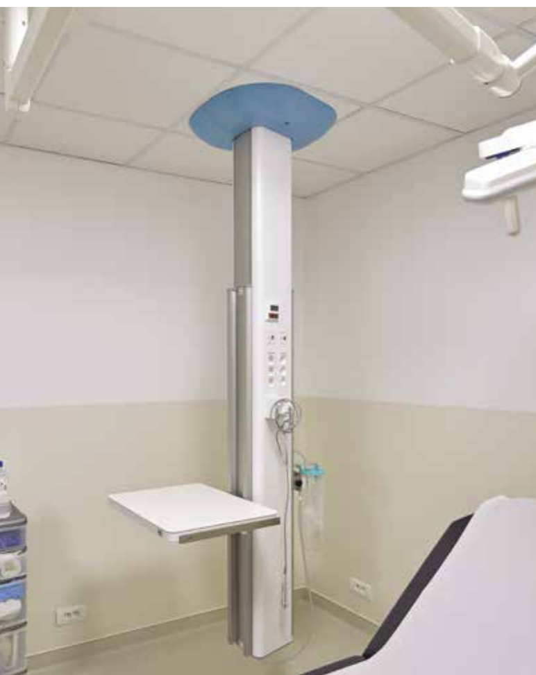
Hôpital Privé des Côtes d'Armor, Plérin Côtes d'Armor Private Hospital, Plérin - France
